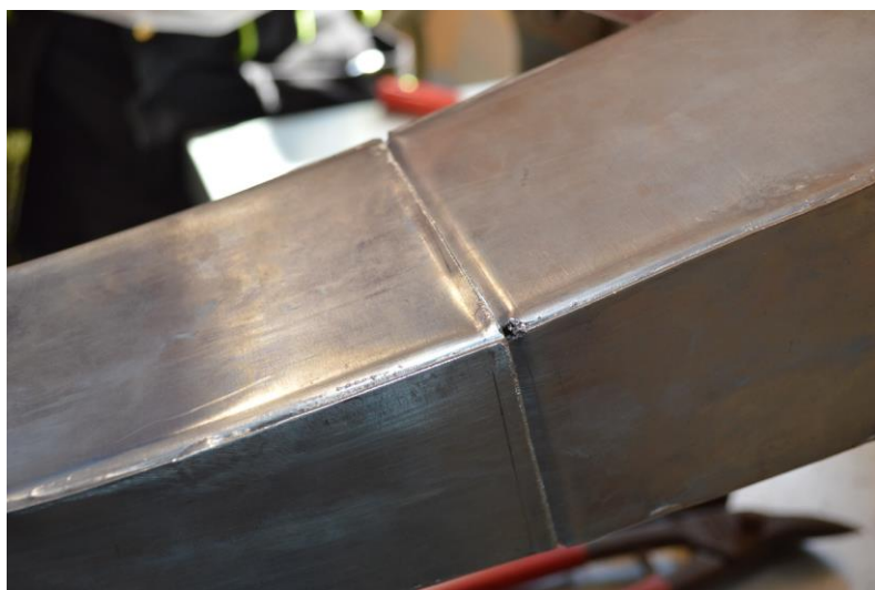
Nedløpet er delt og øvre del redusert/krympet slik at den passer inn i den nedre delen.
